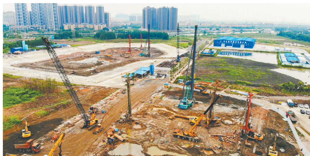
中交四航局承建中山(石岐)总部经济区市政二标项目工地。
