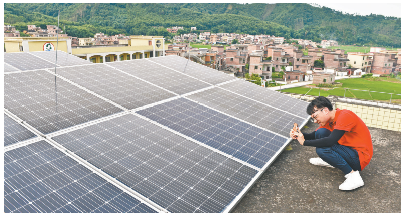
一排排光伏板整齐排列在教学楼顶,这里的光伏项目将持续惠民20多年。
