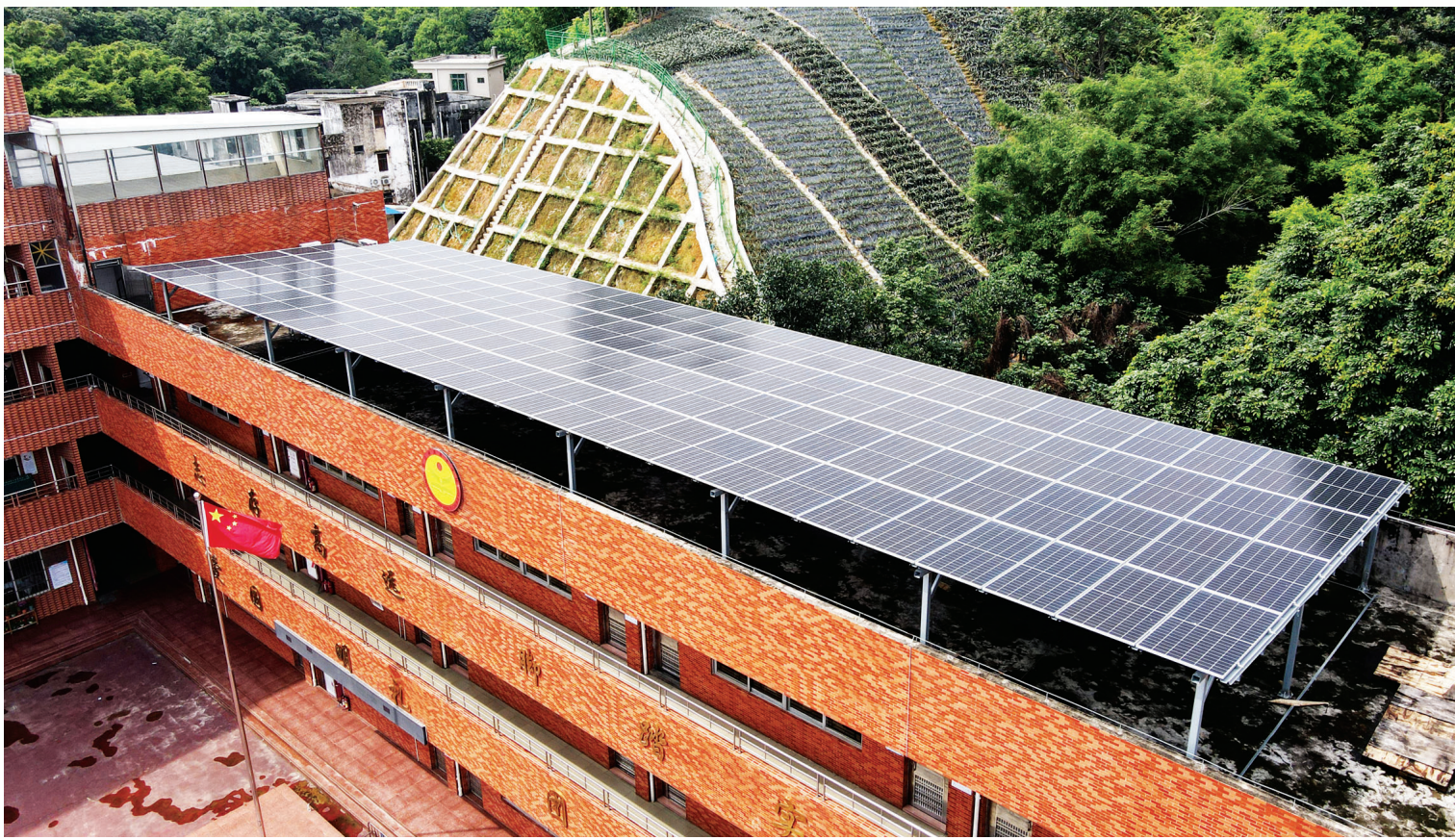
神湾育才学校各楼楼顶都安装了光伏设备。
